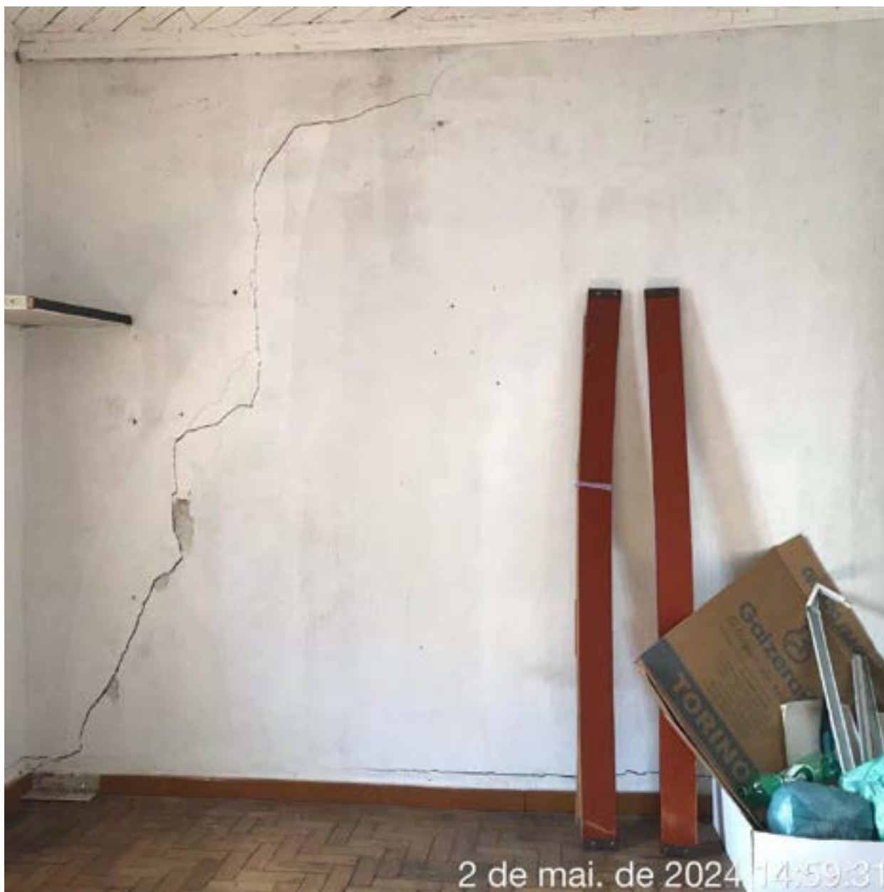
FOTO 7: RACHADURAS PAREDES EDIFICAÇÃO DE Nº 118
