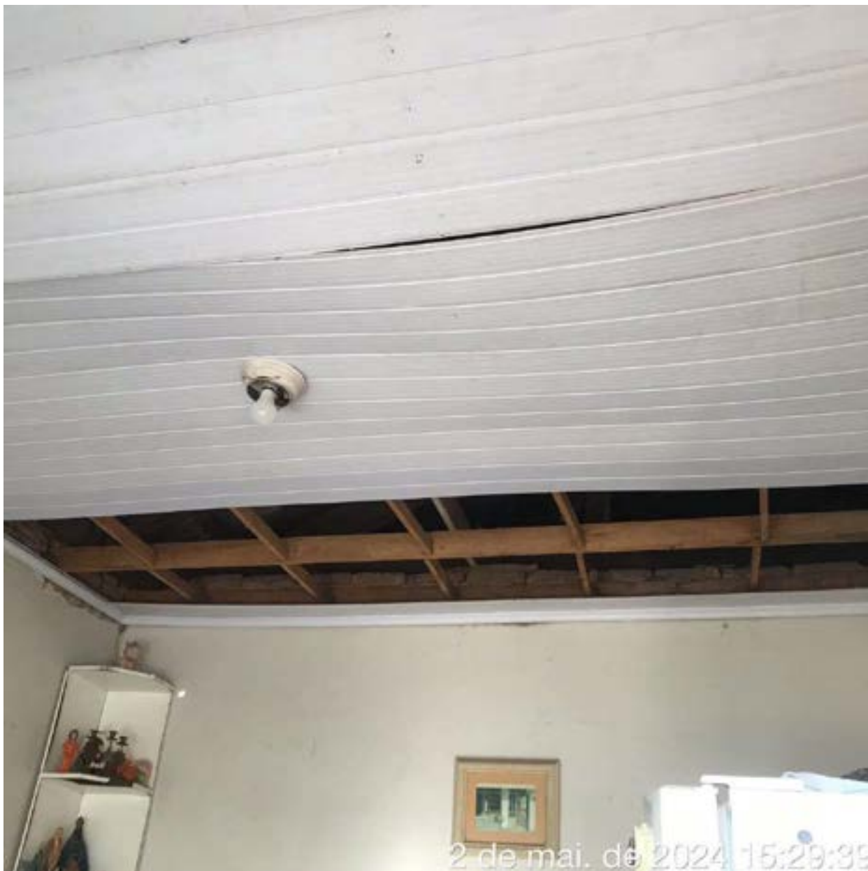
FOTO 14: VEDAÇÃO DANIFICADA – TETO- EDIFICAÇÃO DE Nº 124
