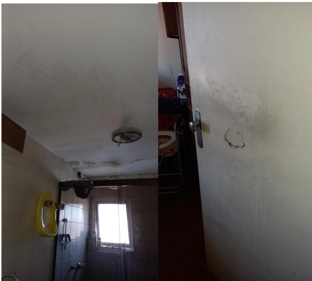
FOTOS 31 e 32: Detalhes do forro com infiltração e porta do banheiro social com perfuração.
