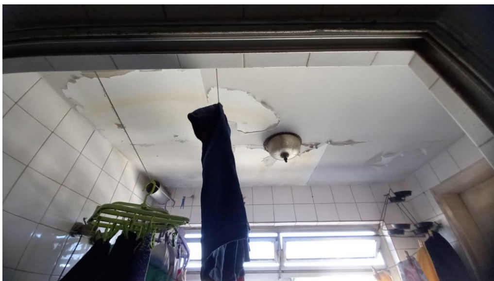
FOTO 22: Teto da área de serviço com infiltrações e falta de manutenção.
