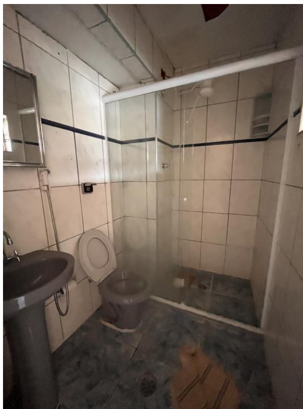
Figura 13: Banheiro irregular, acoplado ao dormitório 2.
