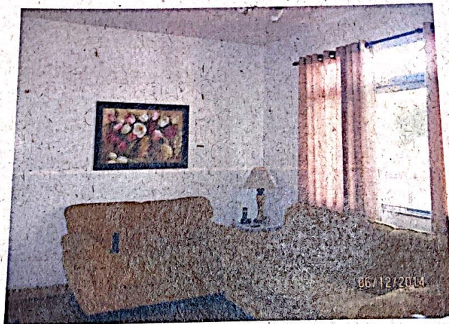
FOTO Nº 02: Vista parcial da sala, que possui os seguintes materiais de acabamento: piso cerâmico, paredes pintadas com tinta látex sobre massa fina, laje de teto pintada com tinta látex e janela de alumínio. Observar o ótimo estado de conservação e manutenção do imóvel.
