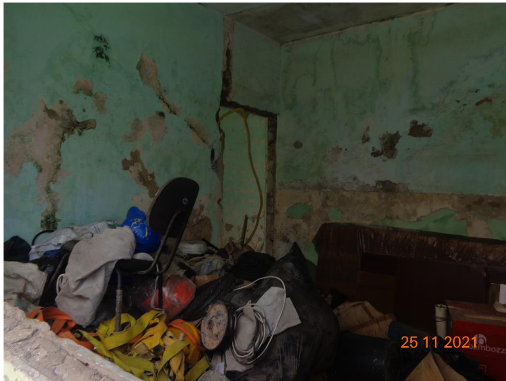
FOTO 12: Vista parcial do interior de outro cômodo da edificação, em estado precário de conservação.
