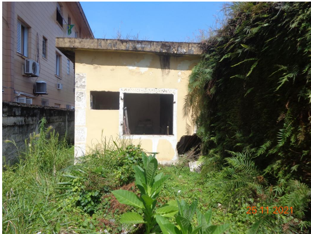
FOTO 08: Vista da parede frontal da edificação, onde se observa a presença de mato / vegetação e vão de abertura de antiga janela sem esquadria.
