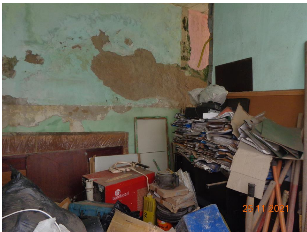
FOTO 11: Vista parcial de outro cômodo da edificação, em estado precário de conservação.
