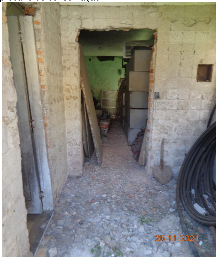
FOTO 13: Vista parcial do interior da edificação, observando-se a retirada de portas/batentes e do revestimento de azulejos das paredes do cômodo.
