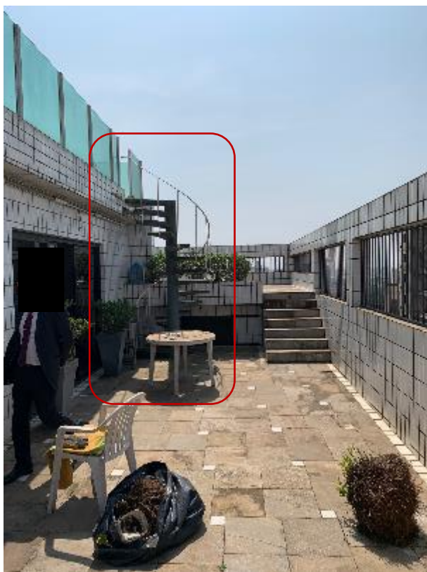
IMAGEM 3 ÁREA EXTERNA DO 2º PISO DESTAQUE A ESCADA DE ACESSO PARA A ZONA DE INVASÃO DA ÁREA COMUM DO CONDOMÍNIO
