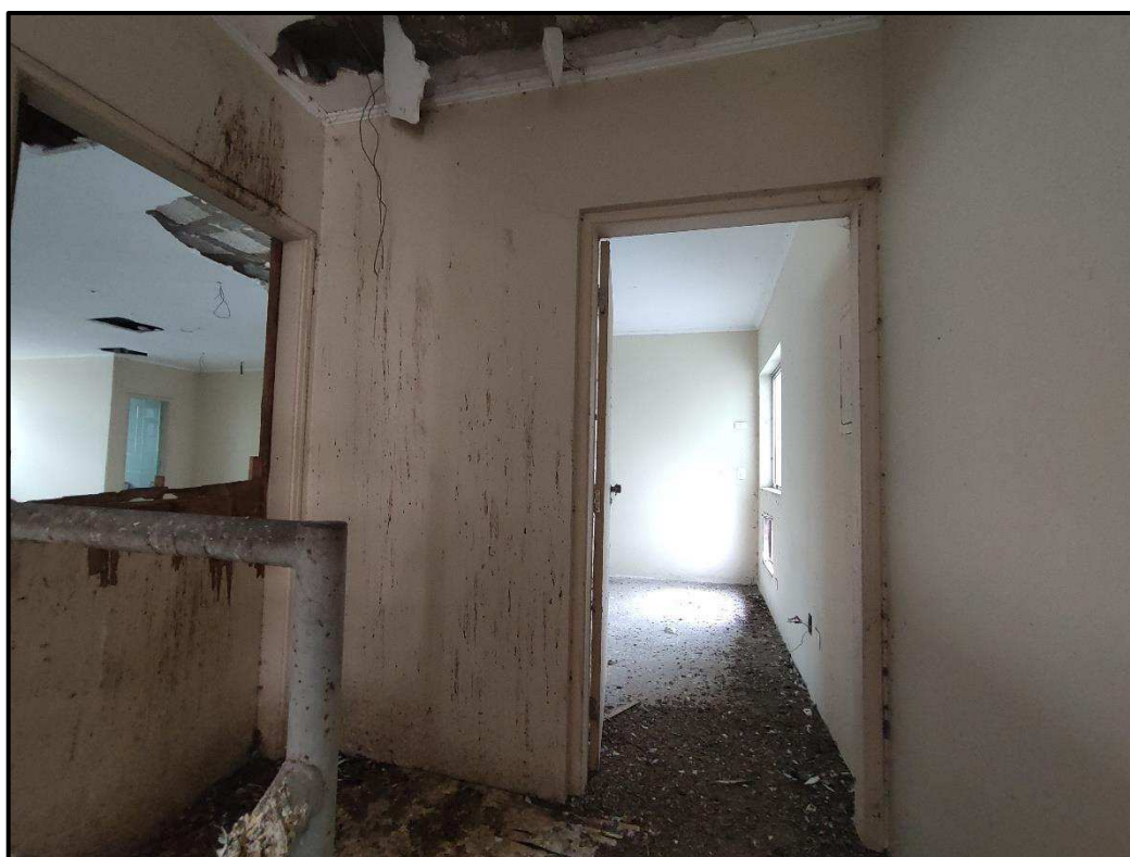
Foto 23: Vista interna do imóvel – Acesso a sala do piso superior (6º pavimento)
