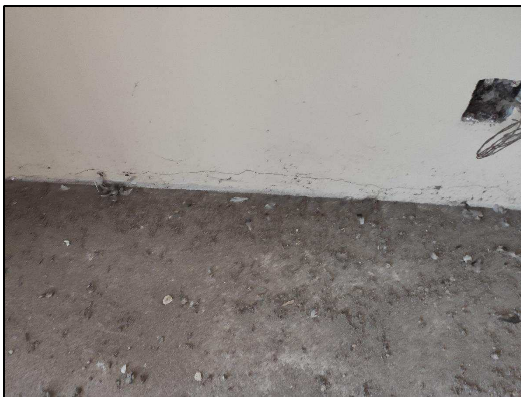
Foto 31: Vista interna do imóvel - trincas na parede
