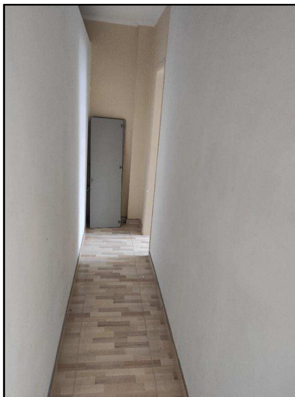
Foto 23: Vista interna do imóvel – Corredor
