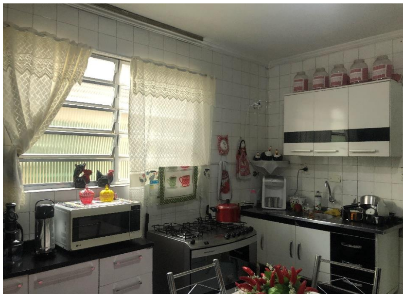
Foto 02 – Vista da cozinha. Suas principais características construtivas são: piso cerâmico, paredes azulejadas até o teto, forro em laje e esquadrias de alumínio.
