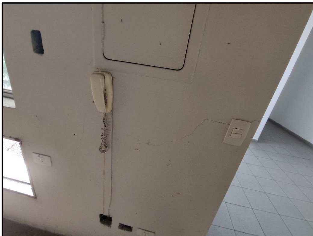
Foto 24: Vista interna do imóvel – Trincas na parede
