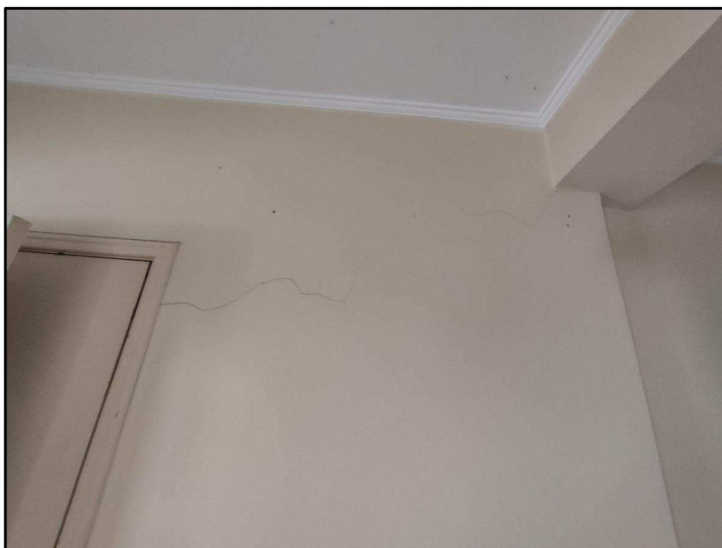
Foto 25: Vista interna do imóvel – Trincas na parede
