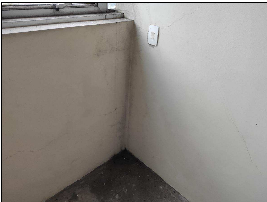
Foto 20: Vista interna do imóvel – umidade e trincas na parede
