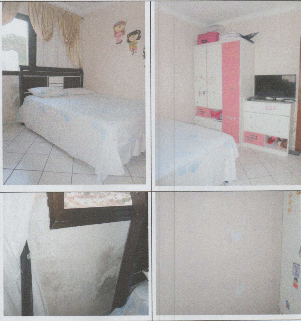
FOTO-SÉRIE 19 - ASPECTO GERAL DOS DORMITÓRIO LATERAL, COM SINAIS DE UMIDADE SOB O CAIXILHO E DANOS À PINTURA DE SUAS PAREDES.
