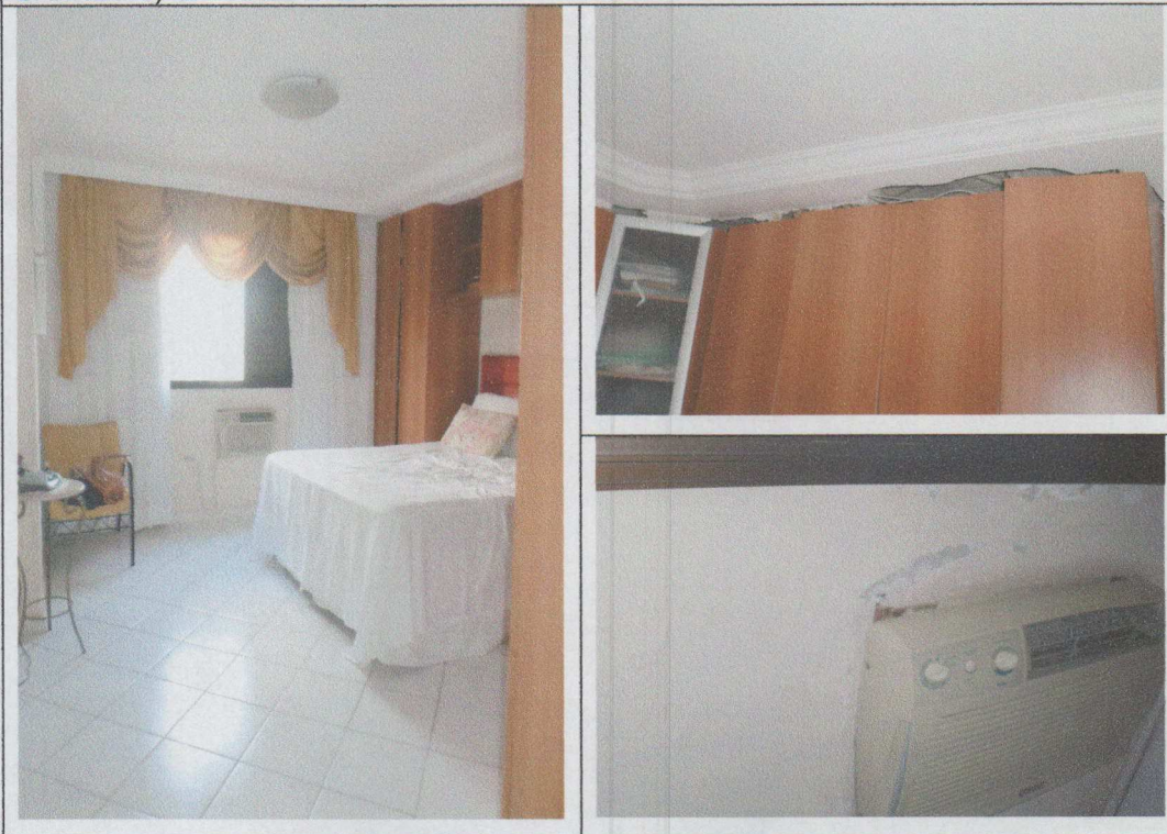
FOTO-SÉRIE 17 - ENFOQUES DO DORMITÓRIO FRONTAL, FOCALIZANDO, NAS IMAGENS MENORES, DANOS DECORRENTES DE UMIDADE NO TETO (JUNTO AO BANHEIRO) E PAREDE EXTERNA.
