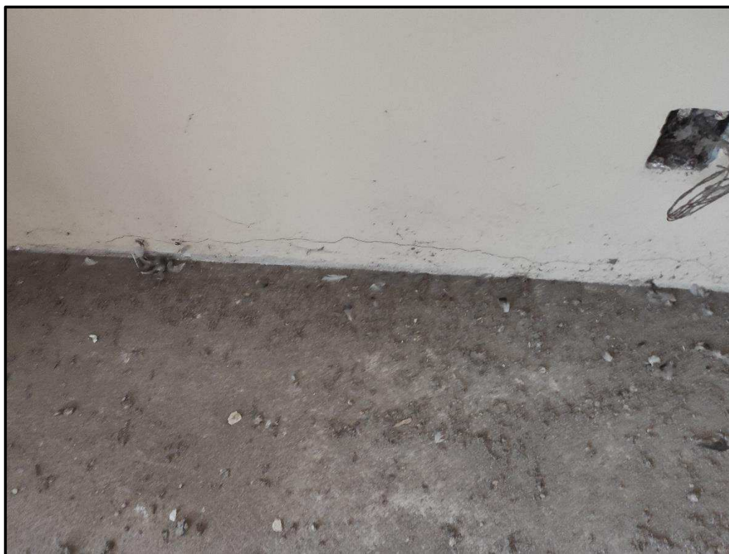
Foto 31: Vista interna do imóvel - trincas na parede
