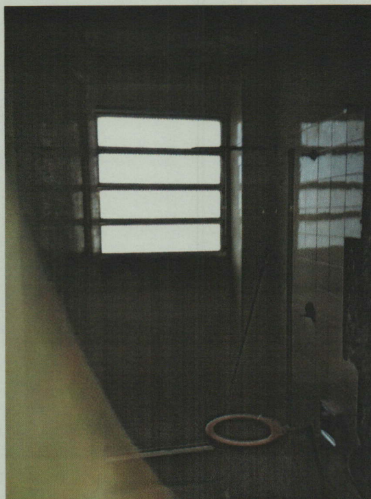
FOTO 3 – VISTA DO BANHEIRO SOCIAL NECESSITANDO DE REPAROS
