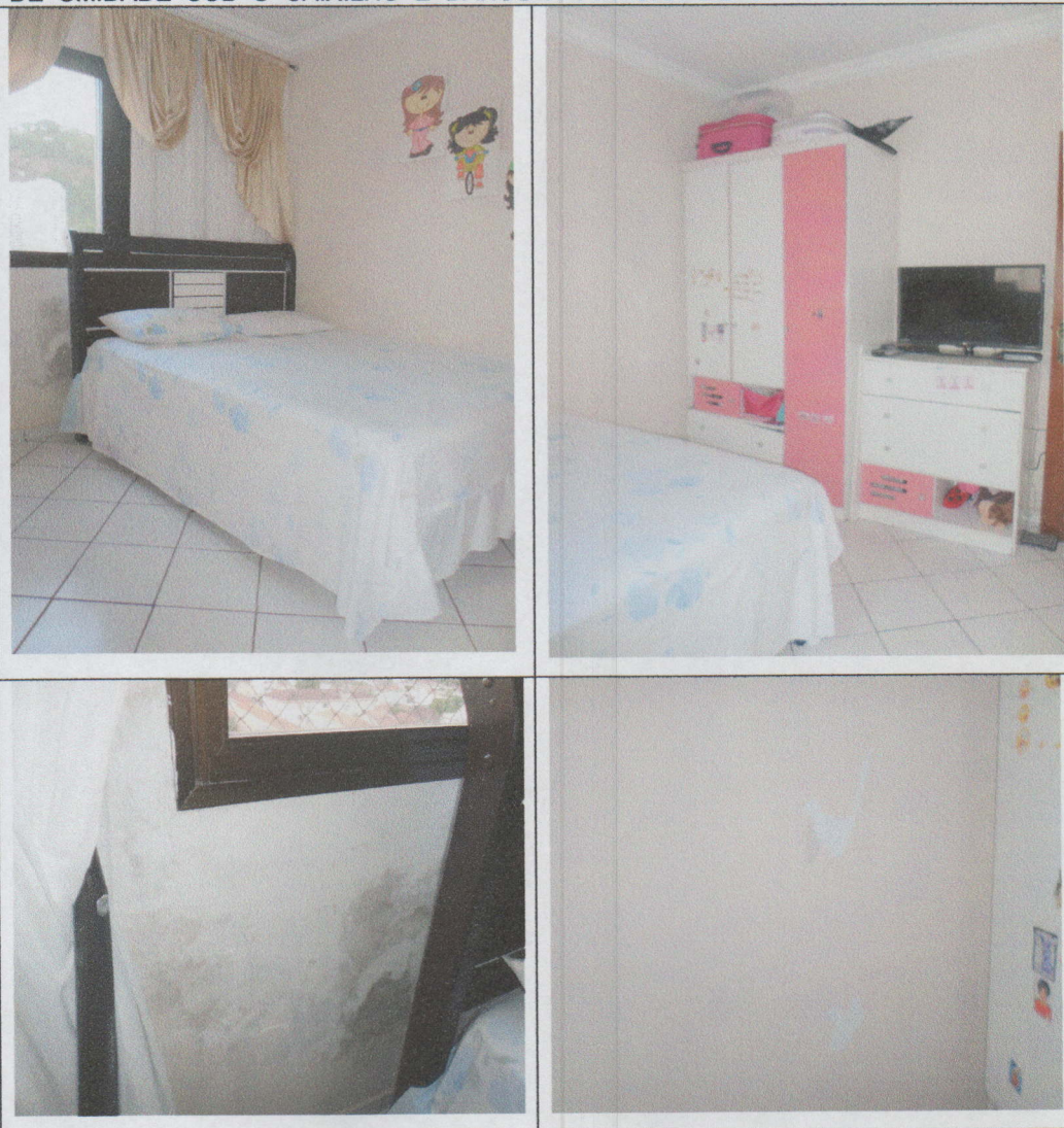
FOTO-SÉRIE 19 - ASPECTO GERAL DOS DORMITÓRIO LATERAL, COM SINAIS DE UMIDADE SOB O CAIXILHO E DANOS À PINTURA DE SUAS PAREDES.
