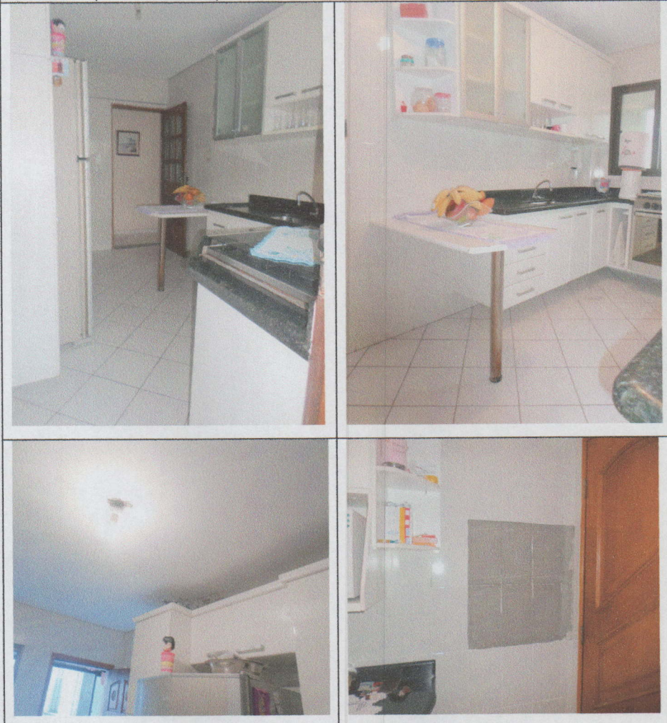
FOTO-SÉRIE 14 - ENFOQUES DA COZINHA, VISTA SOB DIFERENTES ÂNGULOS, MOSTRANDO, NO DETALHE, O DESTACAMENTO DE AZULEJOS.
