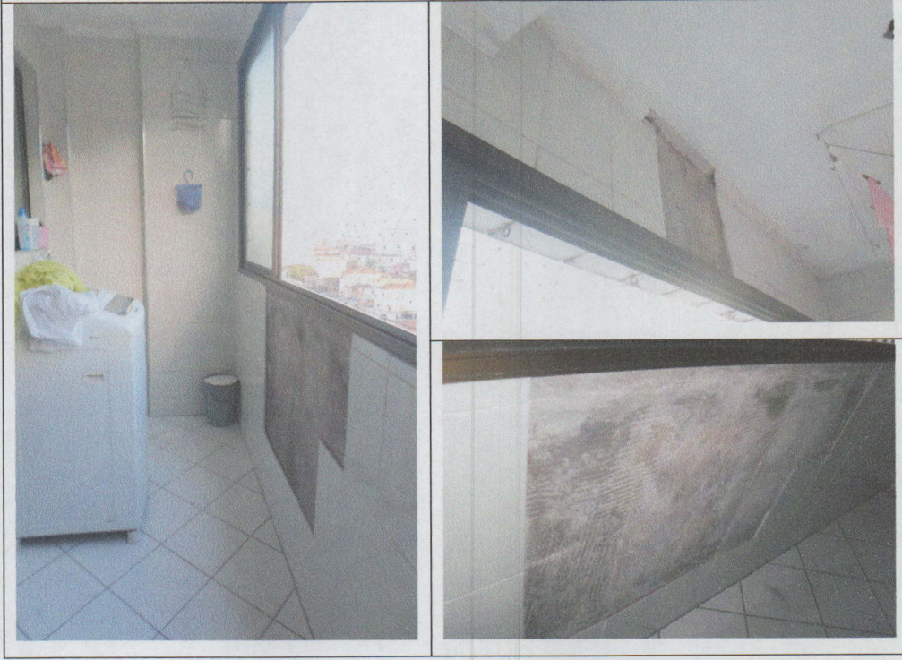
FOTO-SÉRIE 15 - REGISTROS DA ÁREA DE SERVIÇO, FOCALIZANDO O DESTACAMENTO LOCALIZADO DE PEÇAS CERÂMICAS NA PAREDE EXTERNA.
